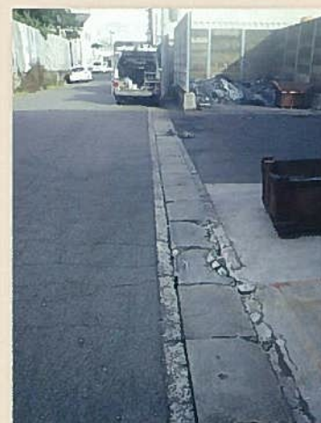
ケース③ 既設側溝、割れ、破損。
