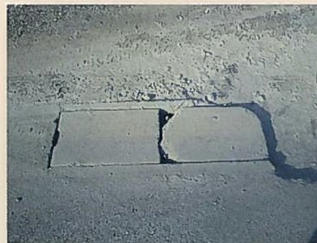
ケース② 既設側溝、ひび割れ、蓋の破損。
